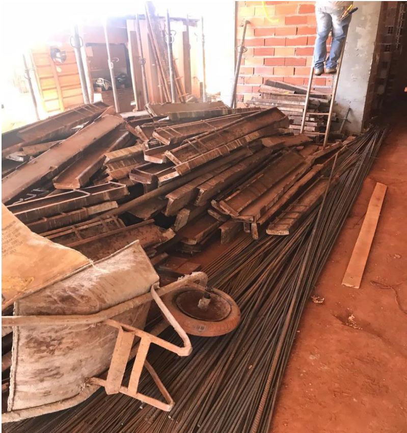
Figura 7. Desordem no canteiro Fonte: Autor (2018).
