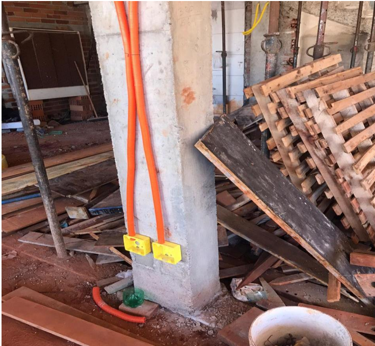
Figura 8. Acumulo de materiais espalhados no canteiro Fonte: Autor (2018).
