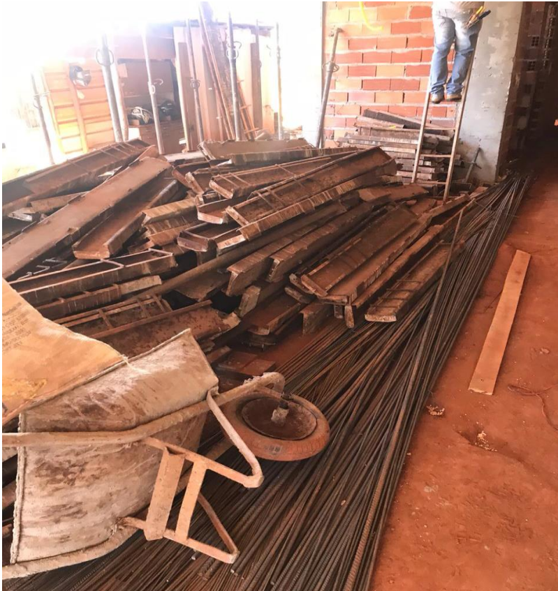
Figura 7. Desordem no canteiro Fonte: Autor (2018).
