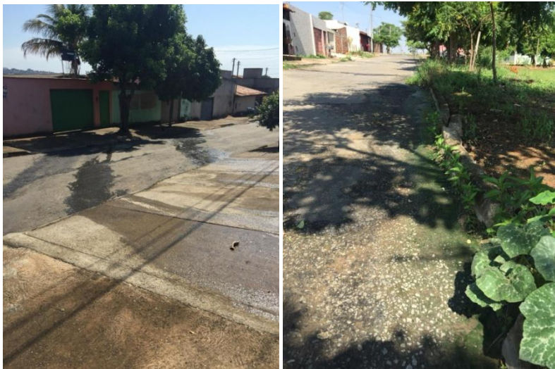
Figura 9. B - Descarte de água doméstica inadequada, A, C - Infiltração no pavimento. Fonte: Autoral.
