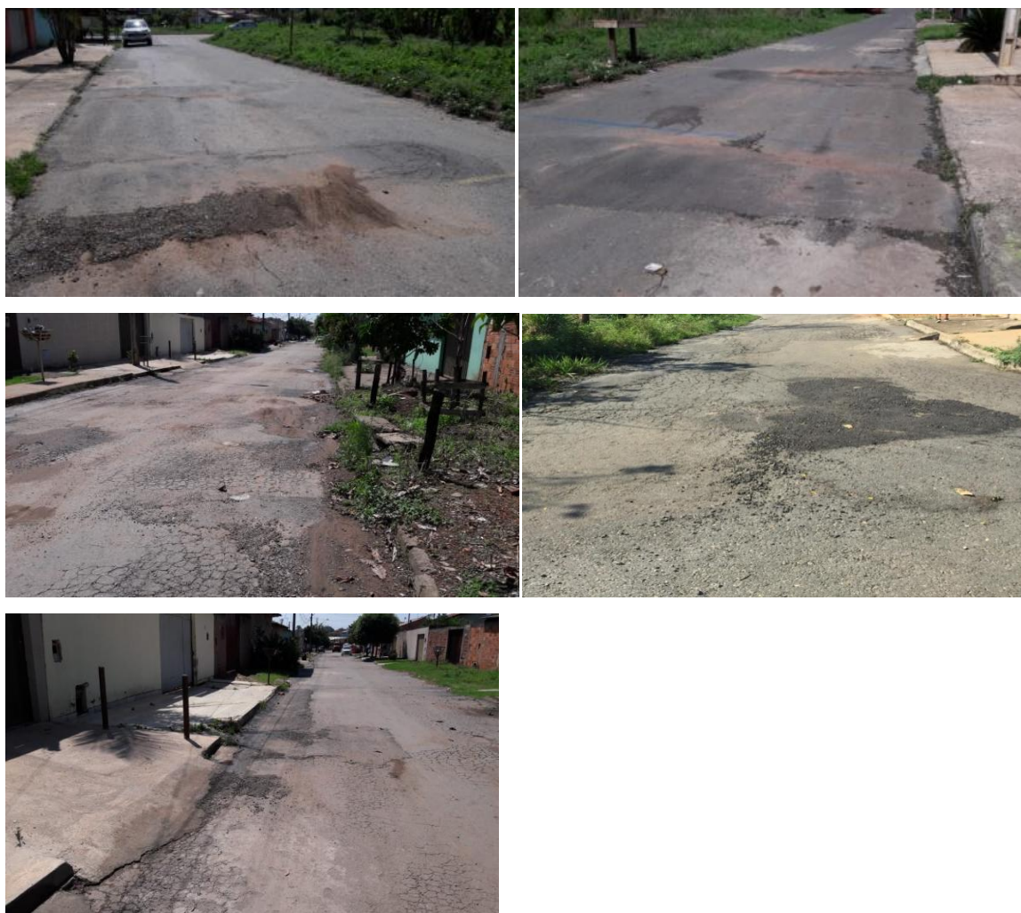
Figura 7. A, B, C, D, E - Situação atual dos buracos reparados em Março. Fonte: Autoral.
