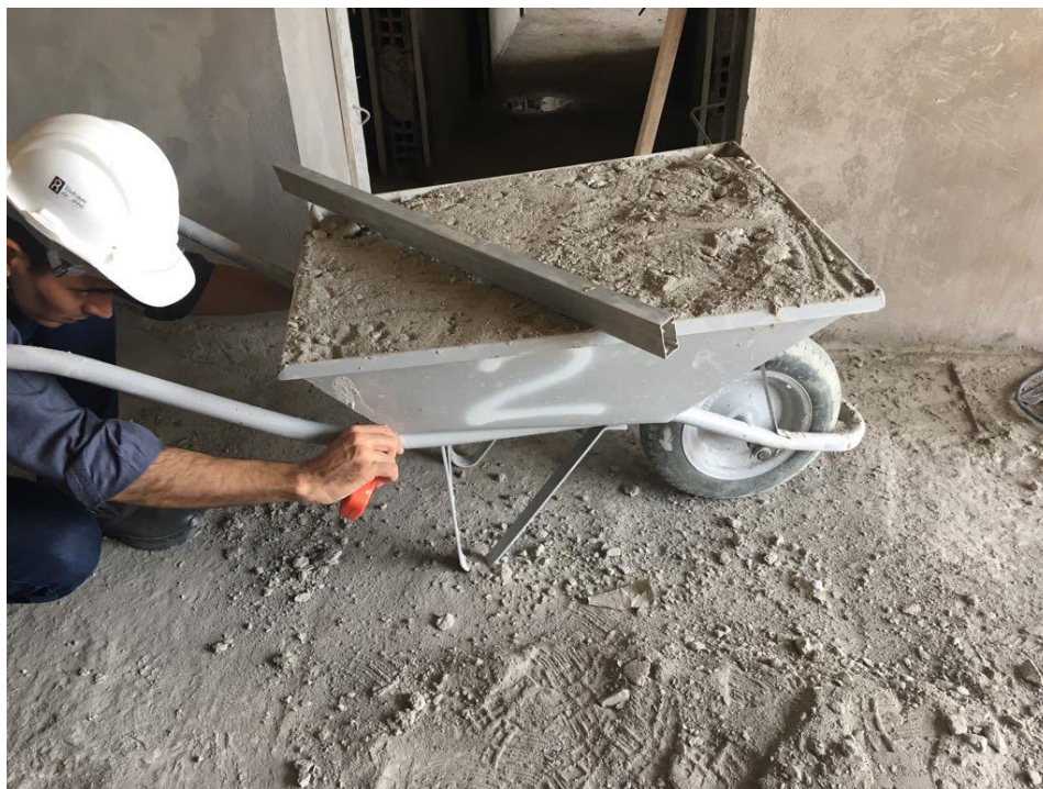
Figura 4 - Medição da perda de argamassa por apartamento.
