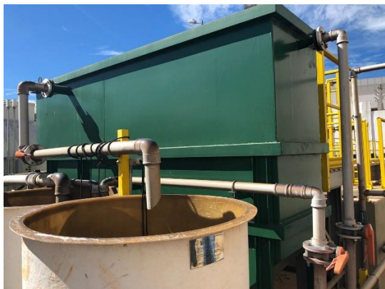
Figura 16: Sistema de tratamento de águas; Pluviais;
