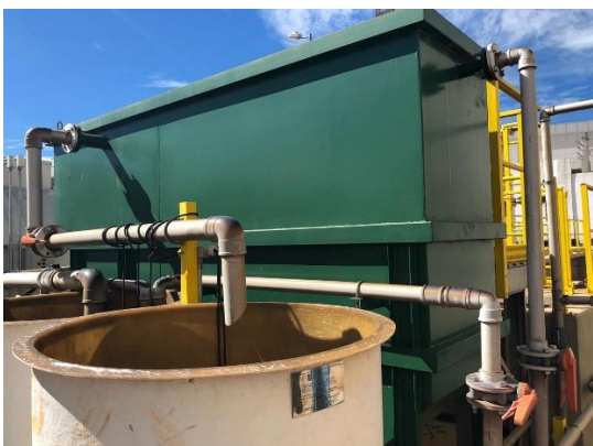
Figura 16: Sistema de tratamento de águas Pluviais;
