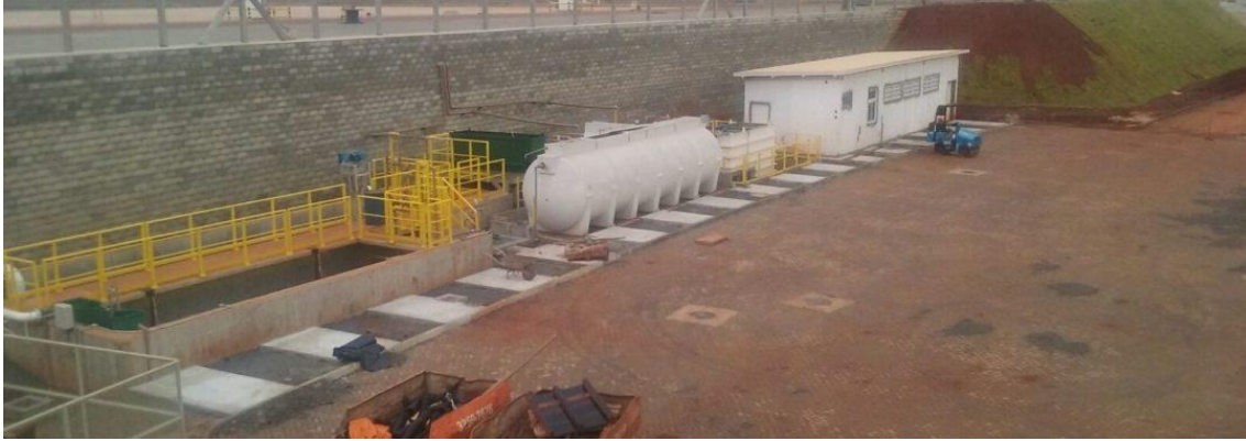
Figura 4: Aeroporto Internacional de Goiânia Tratamento de Águas Pluviais e Cinza para Reuso (ETAPA DE FINALIZAÇÃO) ; Fonte: ECOSAN (2016)
