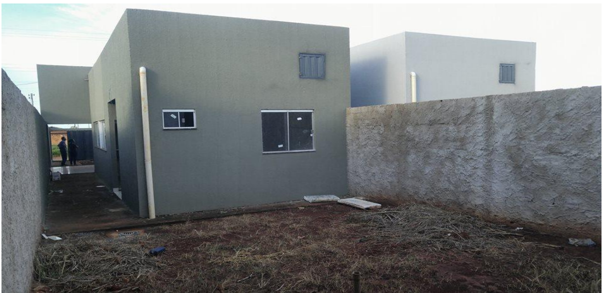
Figura 4 – Fundos da casa no Setor Parque Solimões, Cidade de Goianira – GO Fonte: Rasio Contrutora
